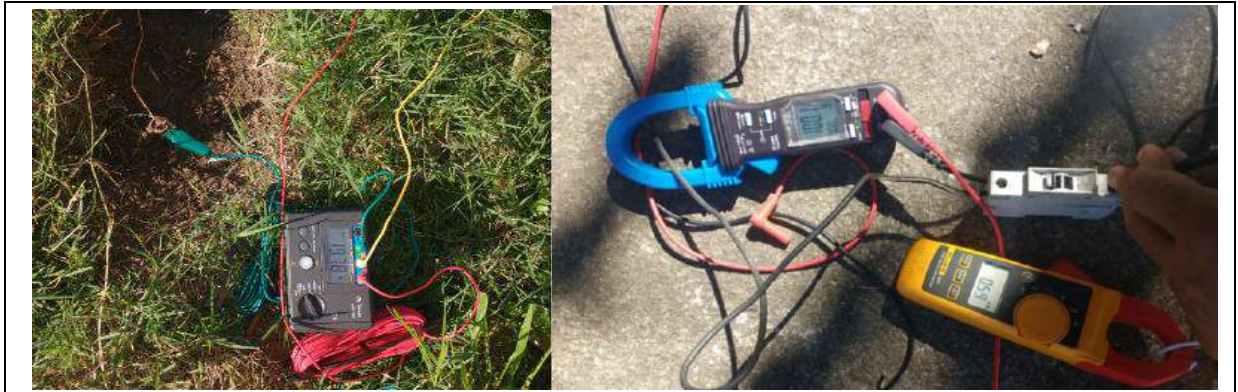
Figura 10 - Instrumentos de medição da resistência, corrente e potência do sistema de aterramento.
